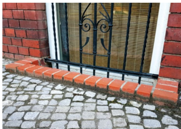
Abbildung 1: Lichtschacht mit kostengünstigem (oberirdischem) Hochwasserschutz (Backsteinreihe); Quelle: GDV
