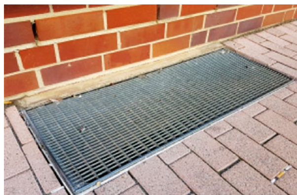
Abbildung 2: Lichtschacht ohne (oberirdischen) Hochwasserschutz; Quelle: GDV
